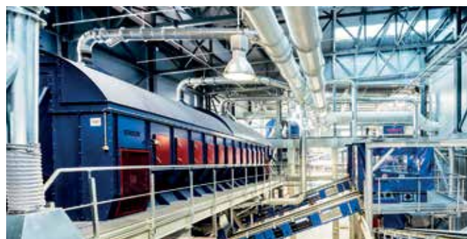
Μονάδα Διαχείρισης Απορριμμάτων Ηλείου
