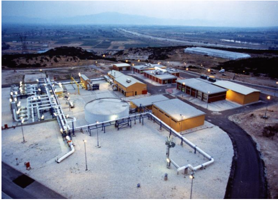
Εικόνα 2: Μεθοριακός Σταθμός Σιδηροκάστρου: Μέτρηση και Ρύθμιση ροής αερίου
