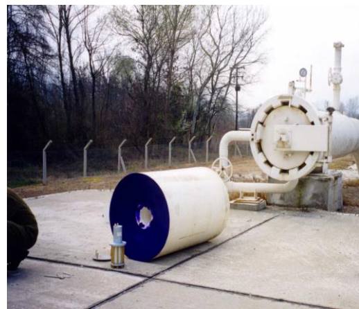
Εικόνα 7: Σταθμοί ξεστροπαγίδων: για την αποστολή και την παραλαβή ξέστρων με σκοπό τον καθαρισμό ή τον εσωτερικό έλεγχο των αγωγών
