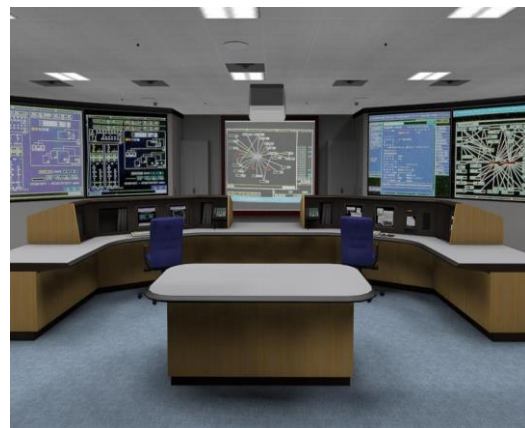
Εικόνα 10: Κέντρο Ελέγχου & Κατανομής Φορτίου
