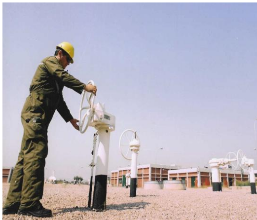
Εικόνα 6: Σταθμοί Βαλβιδοστασιών (Β/Σ) για την απομόνωση τμημάτων του αγωγού ΥΠ
