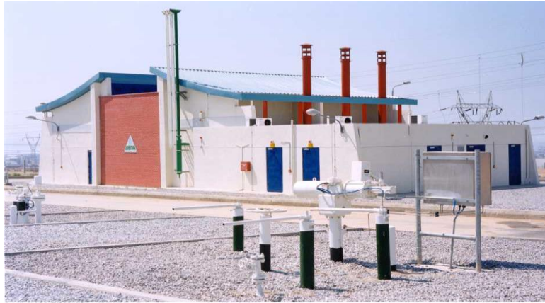
Εικόνα 8: Σταθμοί Μέτρησης και Ρύθμισης
