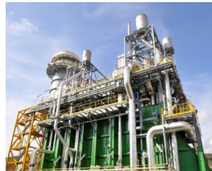
Elpedison Θιάβη 410 MW , β.α. 57%
